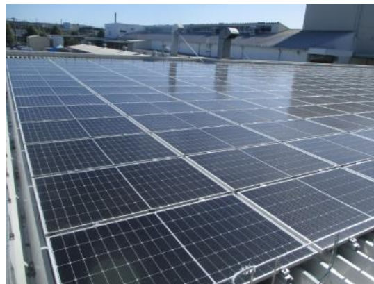
清原本社工場 精密棟の増設太陽光パネル
