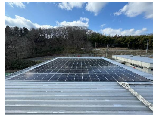
烏山工場の太陽光パネル
